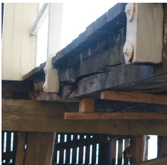
Einige Bauteile der Zugangsbrücke sind schon stark verwittert und müssen 2019 dringend ersetzt werden.
