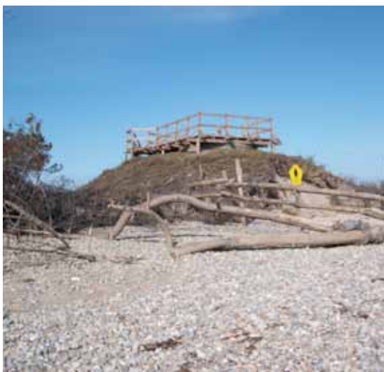
Die Wellen haben sich bis zum Fundament der Kläranlage vorgearbeitet, auf der auch eine Aussichtsplattform steht
